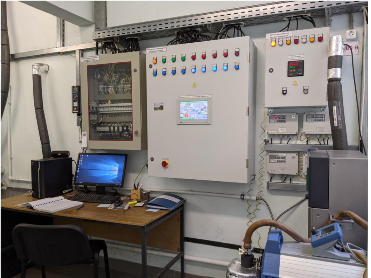
Рисунок 25 – Рабочее место оператора (включает в себя ШУ процессом, ШУ противоаварийной защитой, блок уровнемеров, щит распределения питания, настольный ПК)
